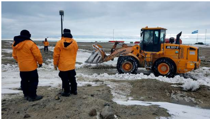
Foto N° 9 y 10: Determinación de desniveles con GNSS y de los trabajos a ejecutar con las máquinas viales para permitir el escurrimiento de las aguas.
