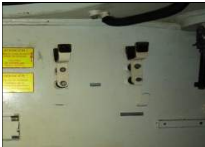
Figura N° 5: "Lugar de instalación del compartimiento"
